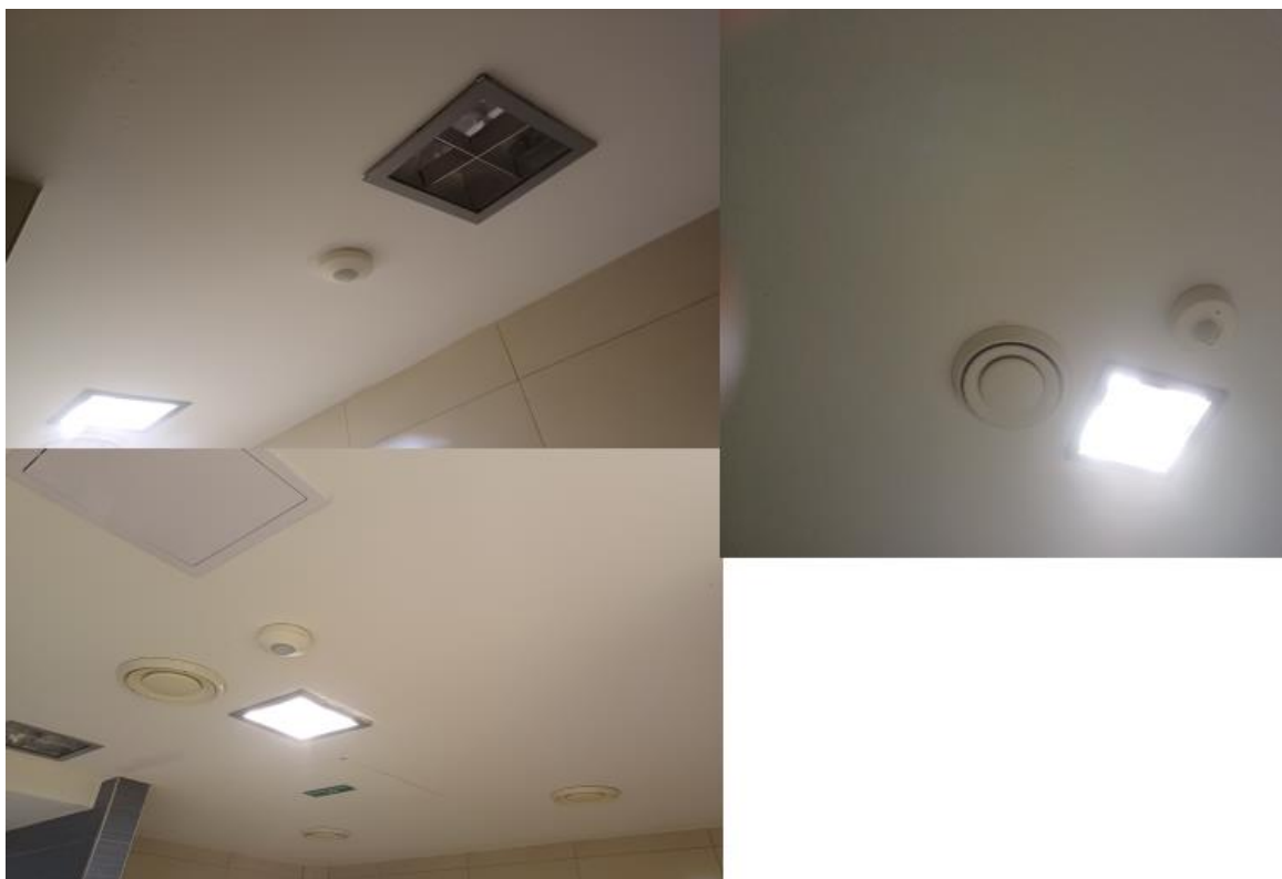
Obrázek 4 - Strop sprchy záchody
