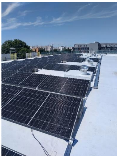
FVE na střeše
