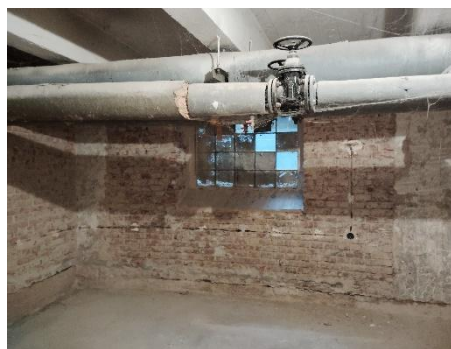
otlučené omítky ve sklepě, okno bude vyměněno ve 2. etapě
